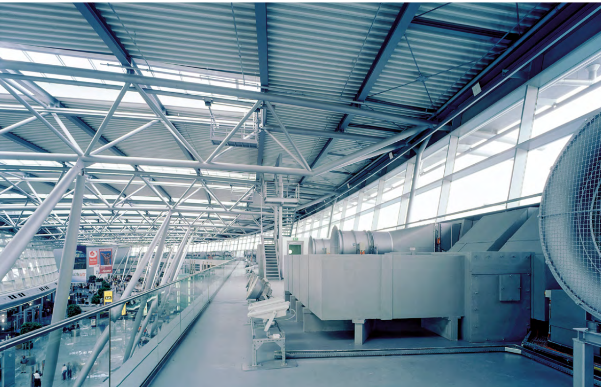
Entrauchungsanlage im Hauptgebäude am Flughafen Düsseldorf
